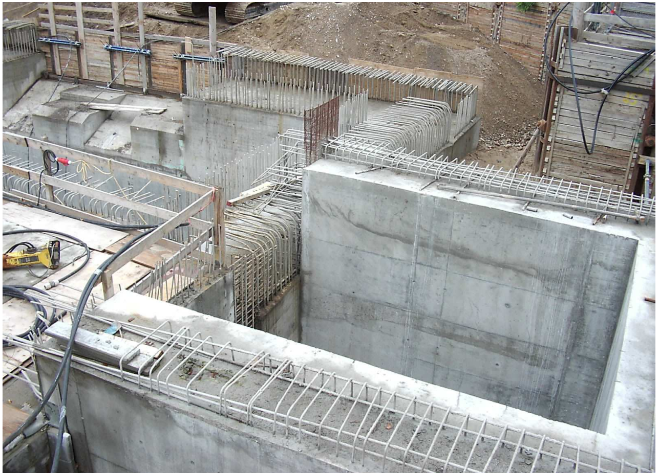
Abb. 7.1: Schacht einer Grundwasserkommunikationsanlage
